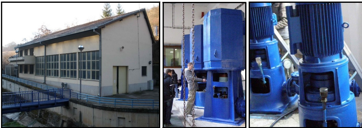
Слика 7 - Пумпна станица „Љубераћа“ и пумпни агрегати за Ниш и Велико Боњинце
